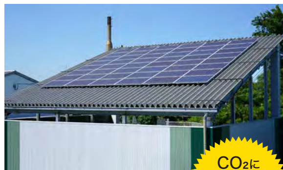
社内設置太陽光パネル
